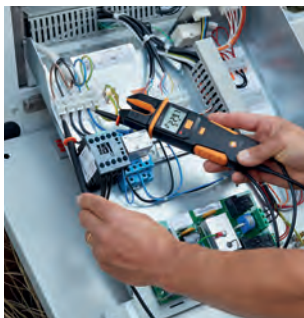
Spanning meten aan een compressor.
