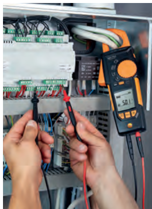
Spanning meting aan het schakelcircuit van een warmtepomp.
