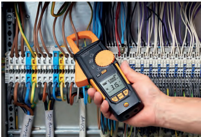
Metten van stroom in een schakelkast.
