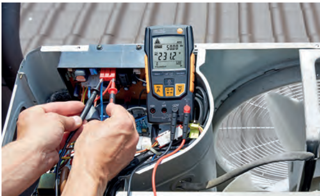
Stroommeting aan een koeltechnische buiteneenheid met de testo 760 .
