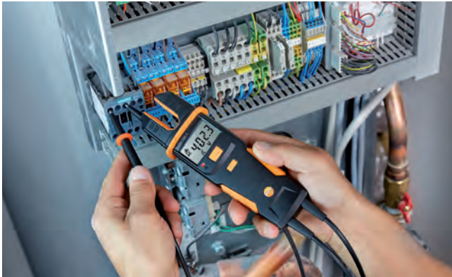
Spanningscontrole aan een warmtepomp met de testo 755 .
