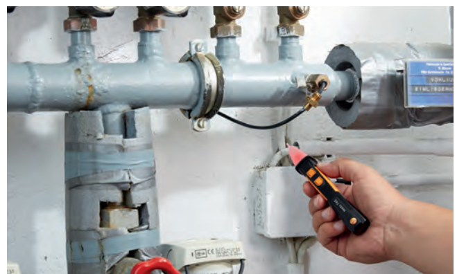
Stroom controle meting met de testo 745 .
