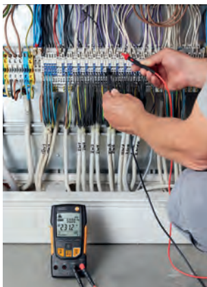
Spanningstest aan een schakelkast.
