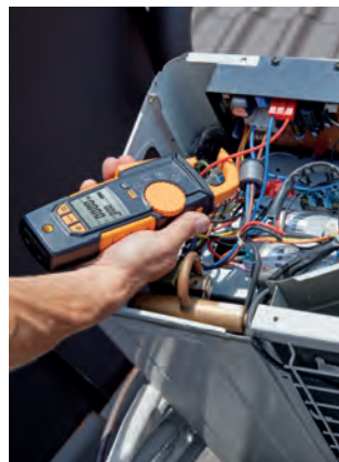
Inhaken van de stroomtang aan een koeltechnische installatie.
