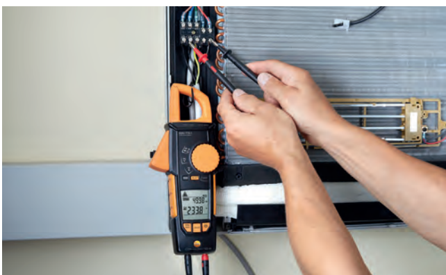
Stroommeting aan een klimaatinstallatie met de testo 770 .
