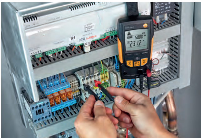
Spanningstest aan schakelonderdeel van een warmtepomp.
