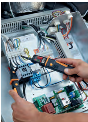
Spanning meten aan een compressor.
