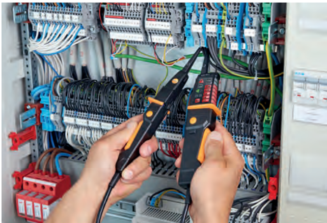
Meten van spanning in een schakelkast.
