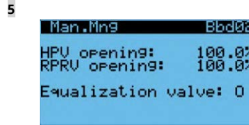
Configurer l'état des soupapes durant le vide O = Ouverte / F = Fermée
